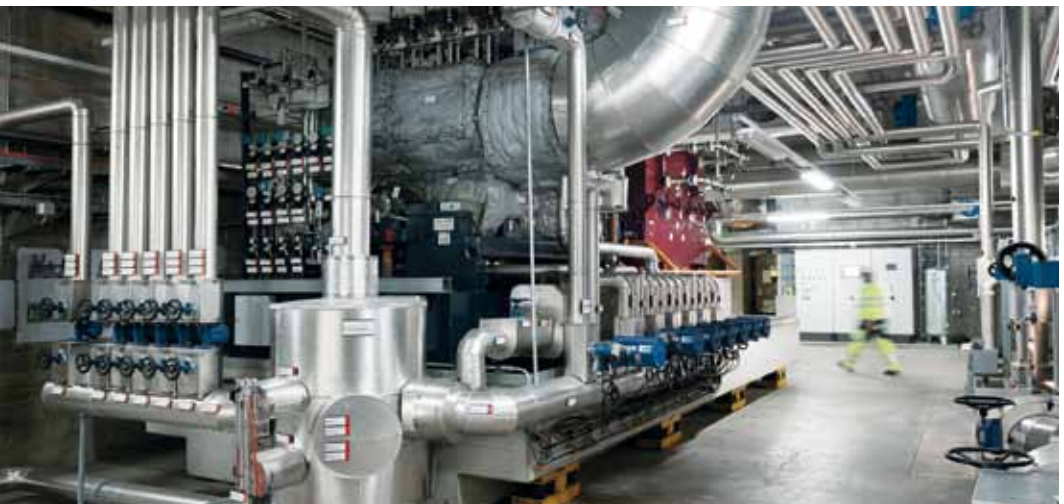
Blick auf die neue Niederdruck-Dampfturbine
