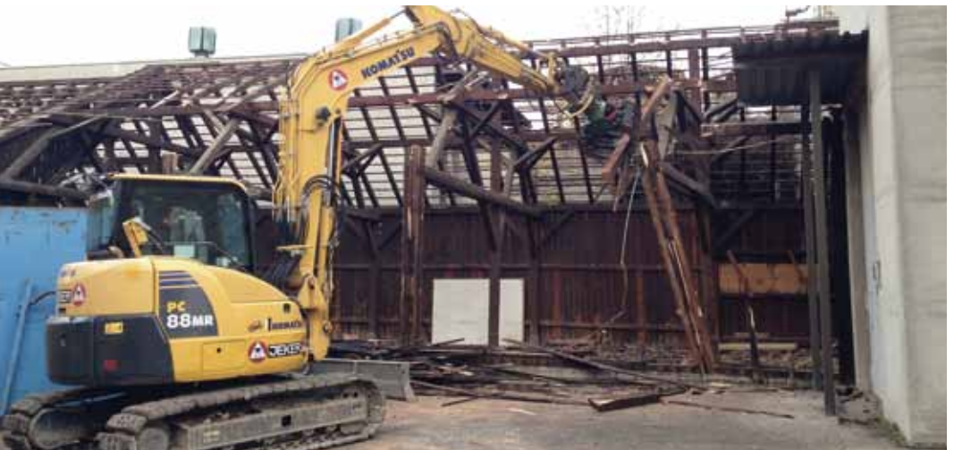
Rückbau der alten Gebäude auf dem Areal der Hamutt AG in Muttenz.
